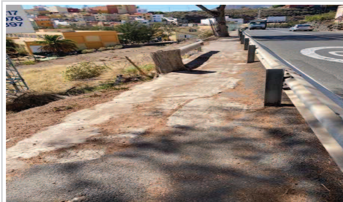
Foto 2. Acceso en mal estado, sin vallado y con arbolado que limita acceso y vallado con la carretera general
